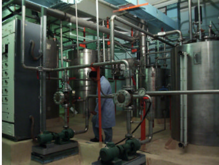
Figura No. 3: Vista parcial del sistema de canalización especial.
